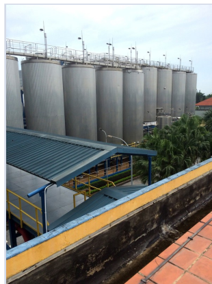
Hệ thống bồn chứa
