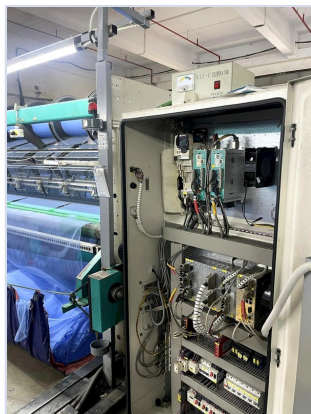
Tủ điện điều khiển
