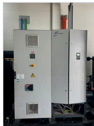
Tủ biến tần công suất lớn
